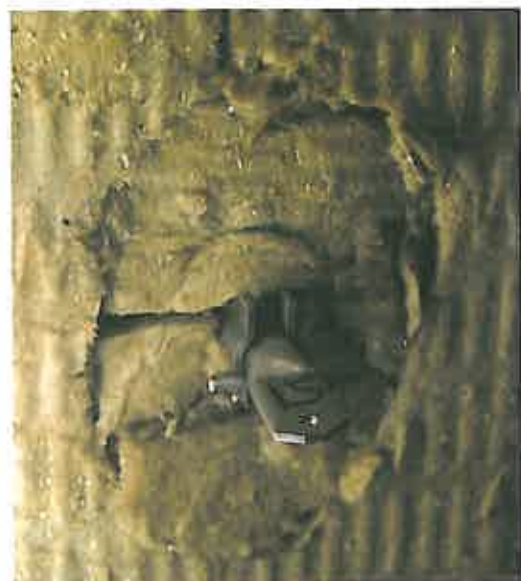
Bild 13 In Dämmstoffoberfläche schlecht "eingelochter" Anker.
